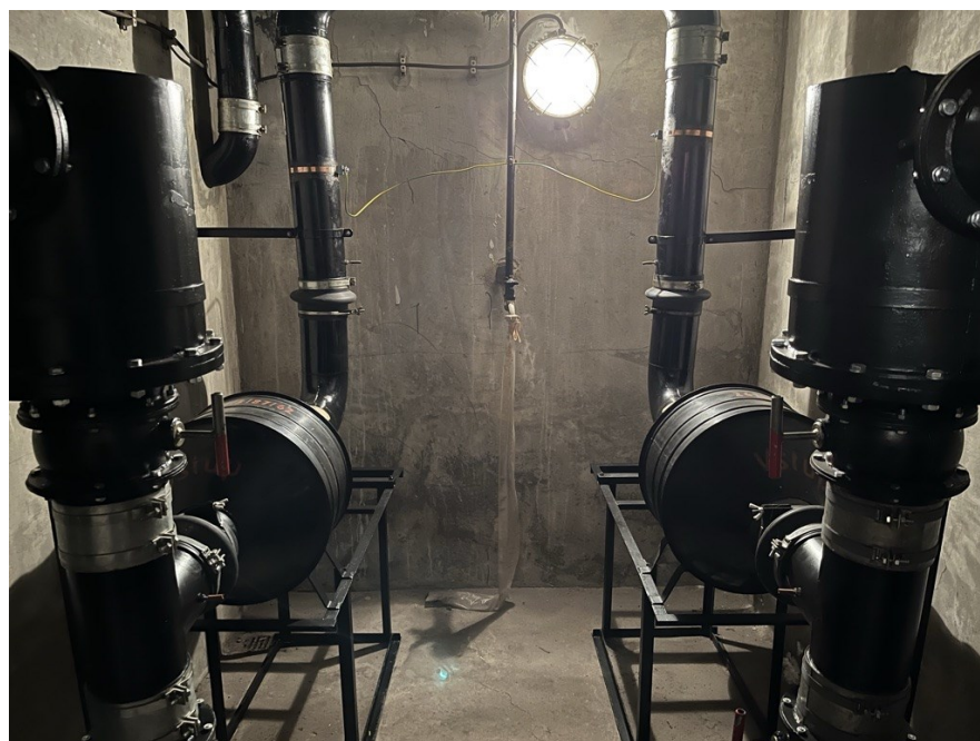
Obrázek 4 – Filtroventilační zařízení. (Vlastní fotografie)
