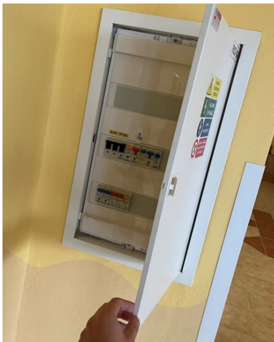
Obrázek 22. Volný přístup k ovládání rozvaděče [vlastní]
