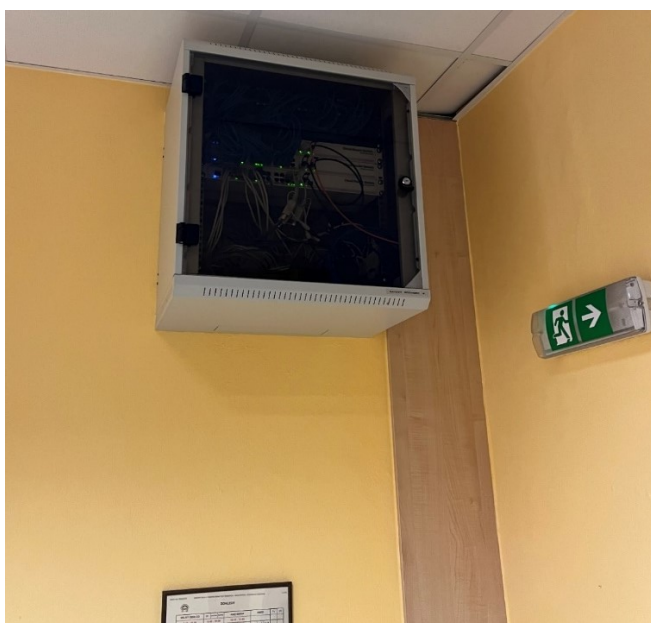
Obrázek 21. Datová skříň na chodbě [vlastní]
