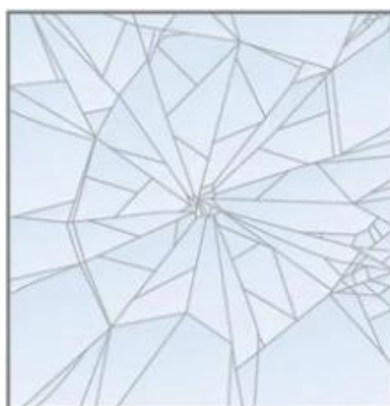
Obr. 17 Vrstvené bezpečnostní sklo poškozené úderem [52]
