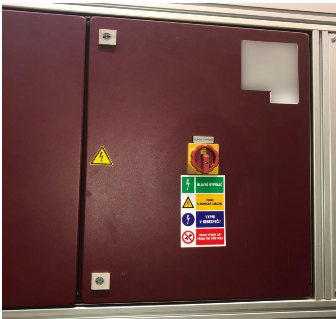
Obrázek 20 Blokováný rozvaděč stroje RoundTable
