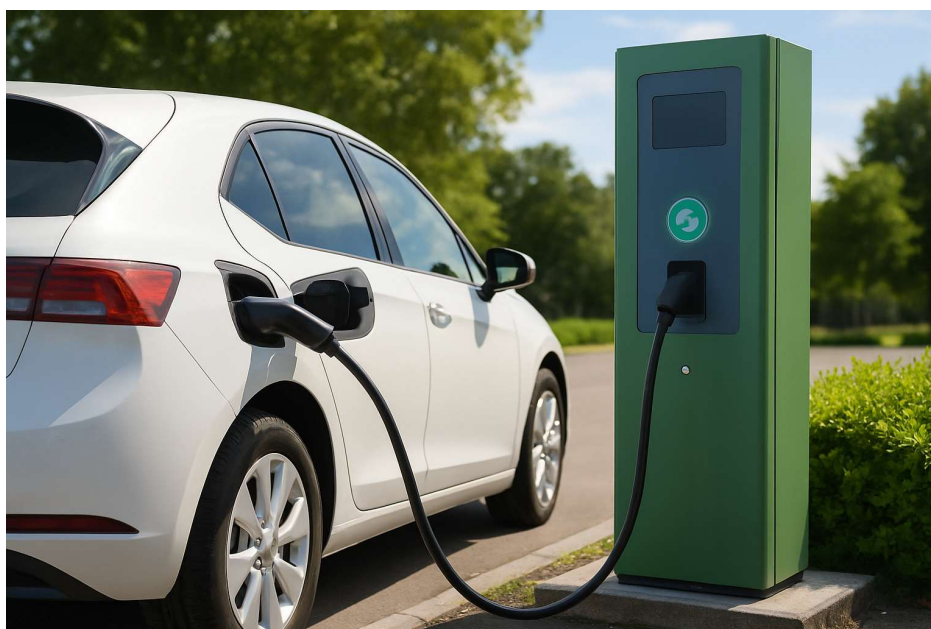
Obrázek 1 Dobíjecí stanice pro elektromobil [5]
