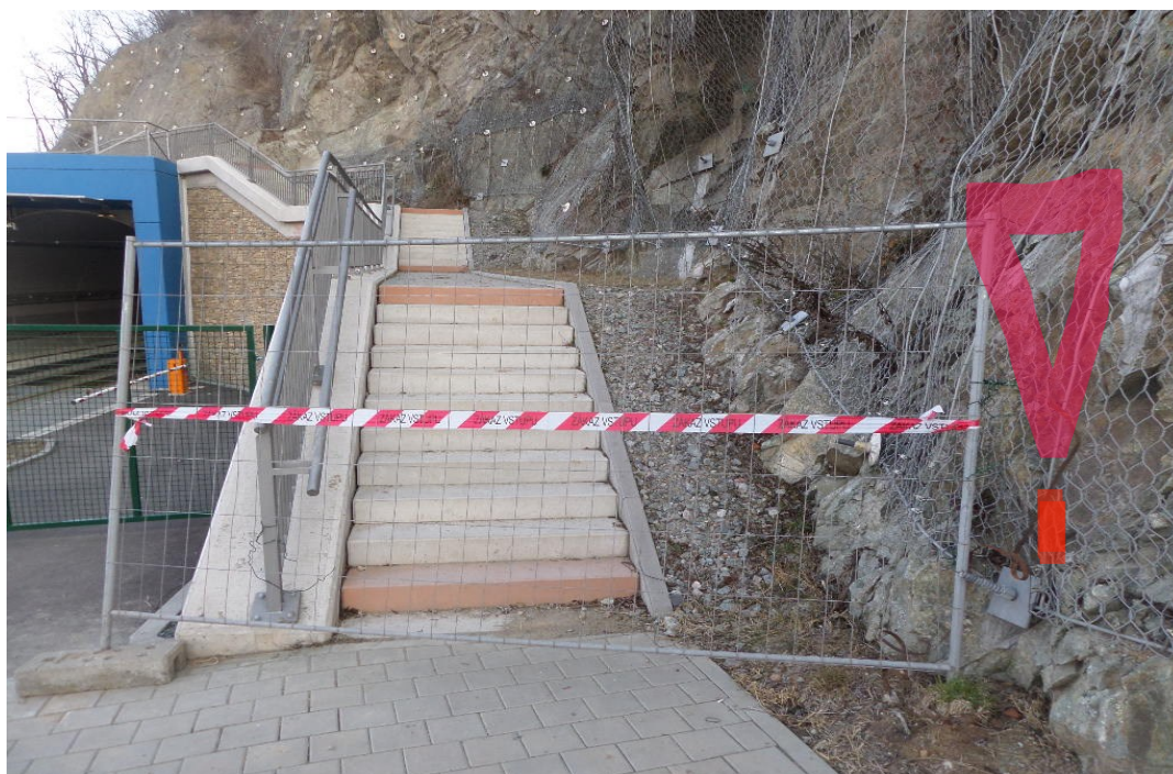
Obrázek 8 Nedostatečné zabezpečení stavby proti vstupu nepovolaných osob
