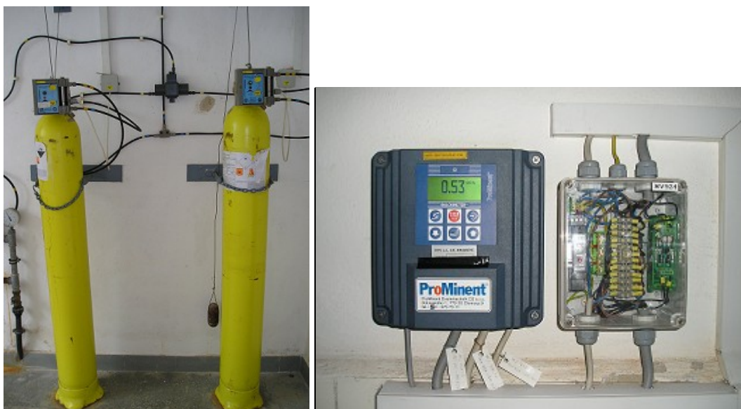
Obr. 4. Dávkování plynného chloru do vody – dezinfekce, kontinuální analyzátor chloru.
