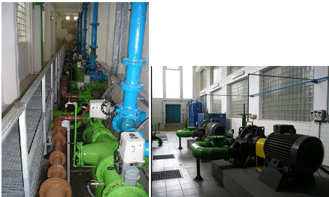
Obr. 3. Příklad praktických technologických stupňů úpravy vody na ÚV Kněžpole (filtry, strojovna)
