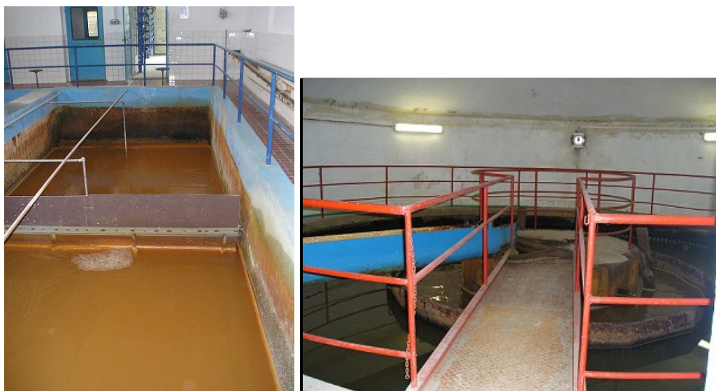
Obr. 2. Příklad praktických technologických stupňů úpravy vody na ÚV Kněžpole (flokulace, sedimentace)
