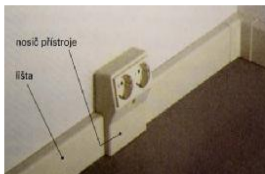
Obr. č. 8: Uložení kabelů v lištách
