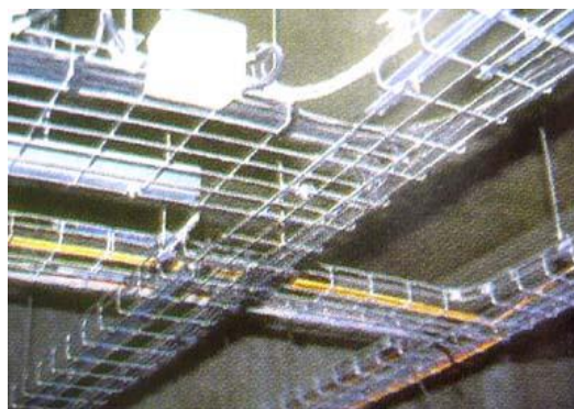
Obr. č. 6: Uložení kabelů ve žlabu
