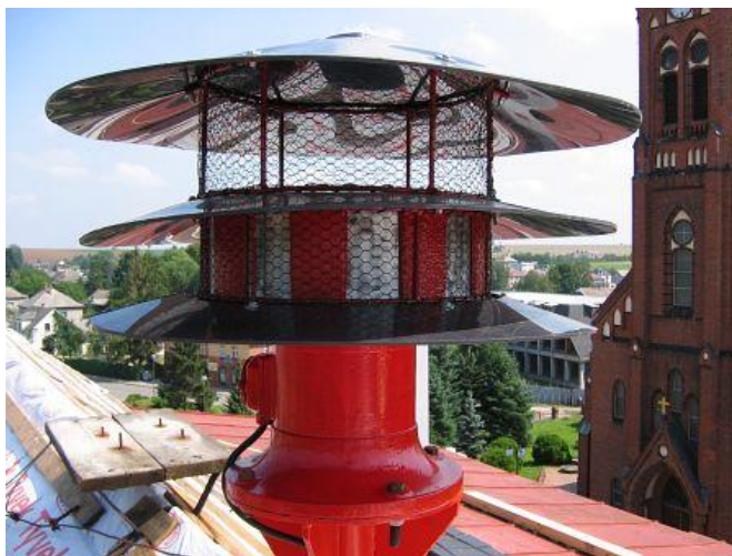
Obr. 5. Elektrická rotační siréna
