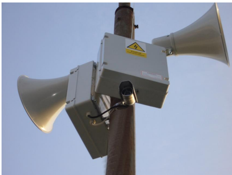
Obr. 12. Místní informační systém ve spojení s kamerovým systémem
