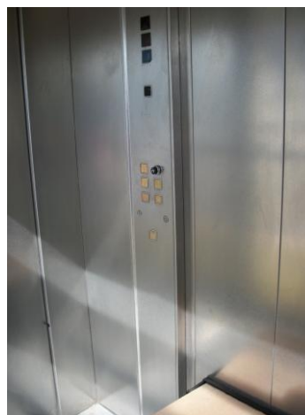
obr. 6 ovládací panel ve výtahu
