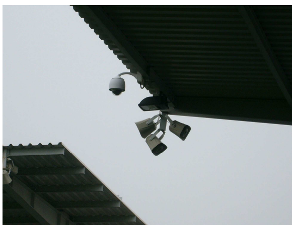
Obrázek č. 3: Kamerový systém stadionu
