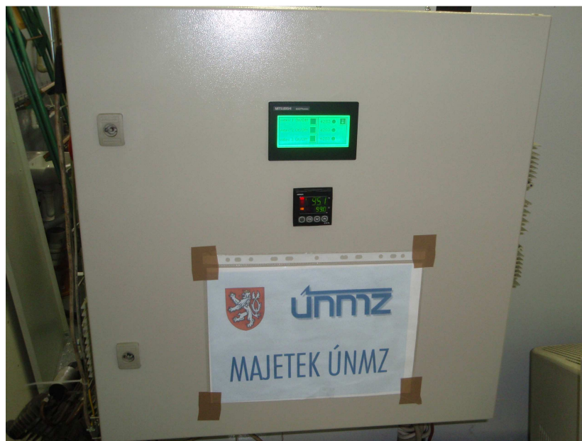
Obrázek č.21 – Hlavní skříň s PLC a rozvody celého okruhu
