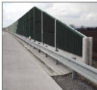
Protihluková clona na dálnici D1 u Mofic.
