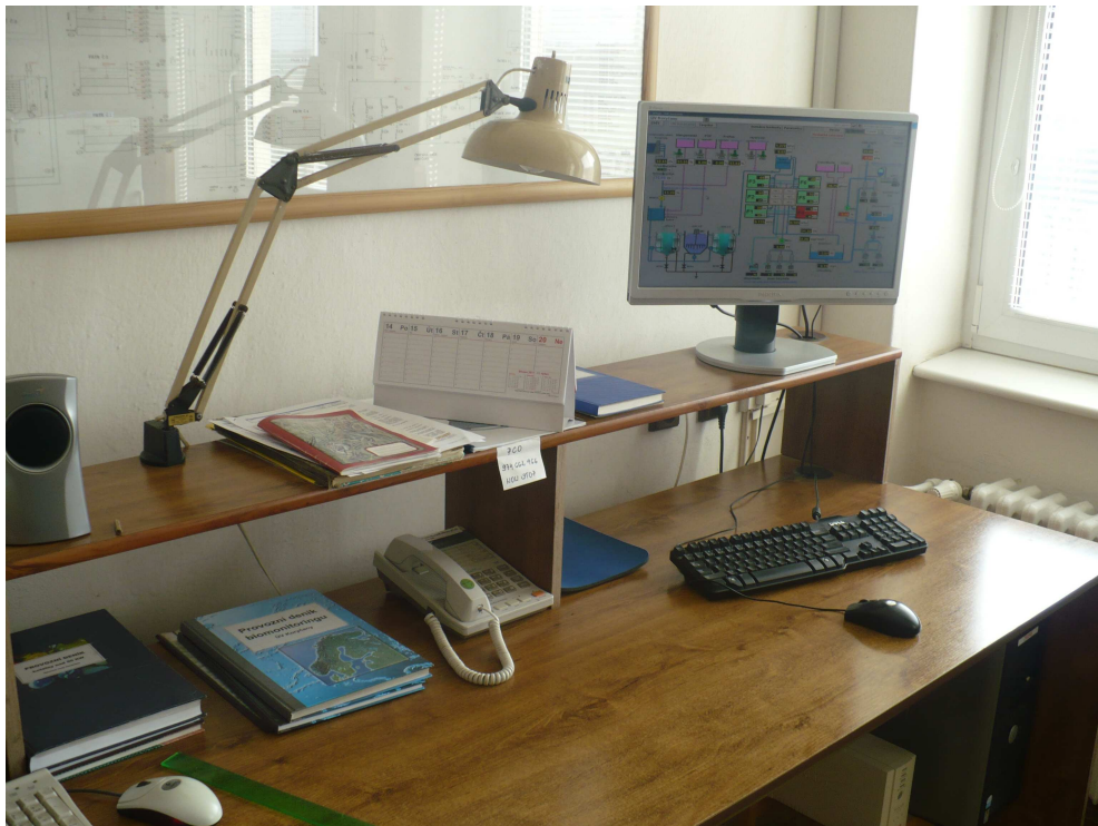
Obr. č. 11: Dispečerské pracoviště obsluhy úpravny
