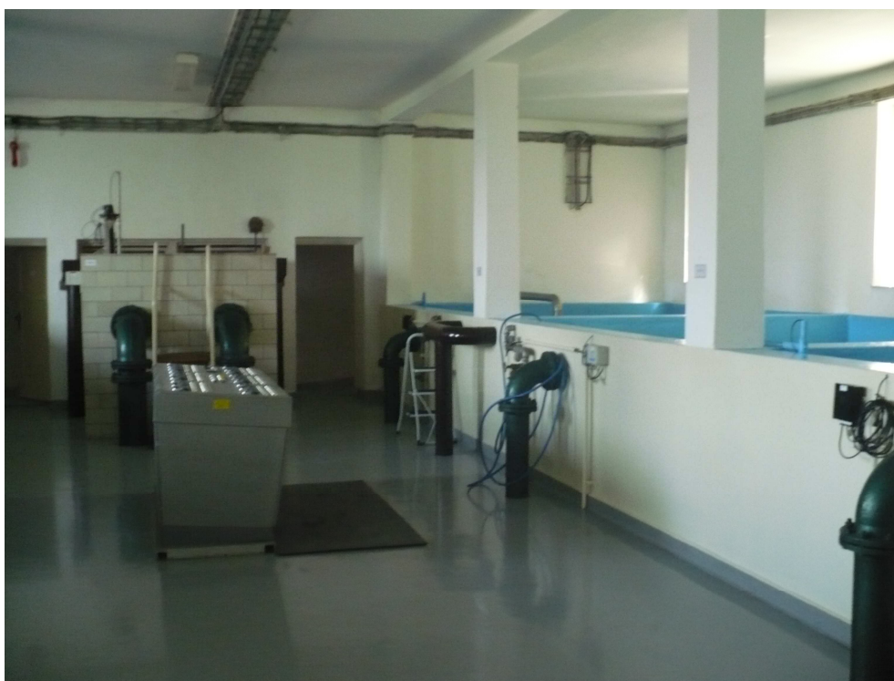
Obr. č. 16: Místnost s pískovými filtry
