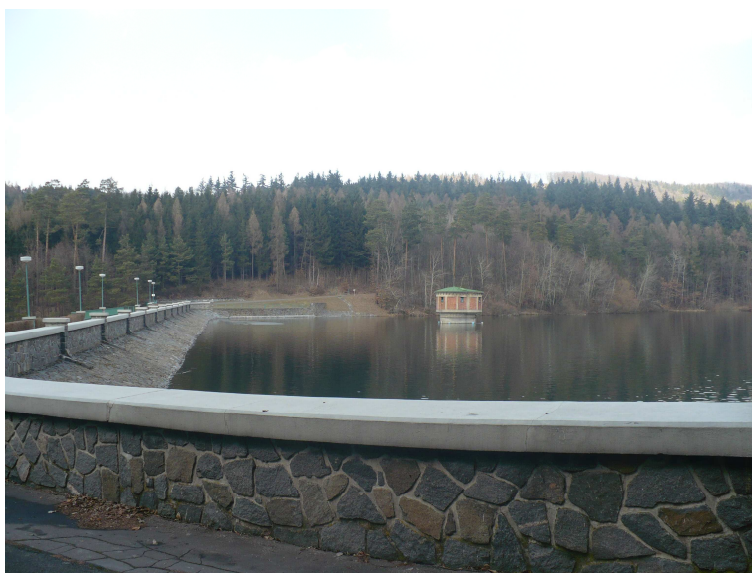
Obr. č. 5: Neoplocená, volně přístupná část hráze a odběrný horizont k jímání surové vody
