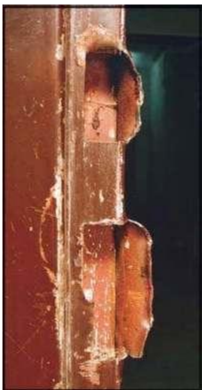
Obr. 41. Zárubeň po vypáčení
