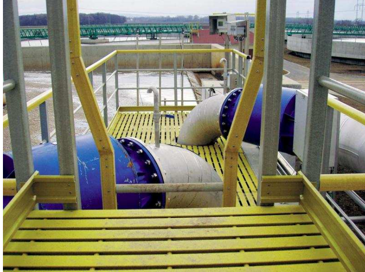
Obr. 5. Čistírna odpadních vod v Brně-Modřicích [2]
