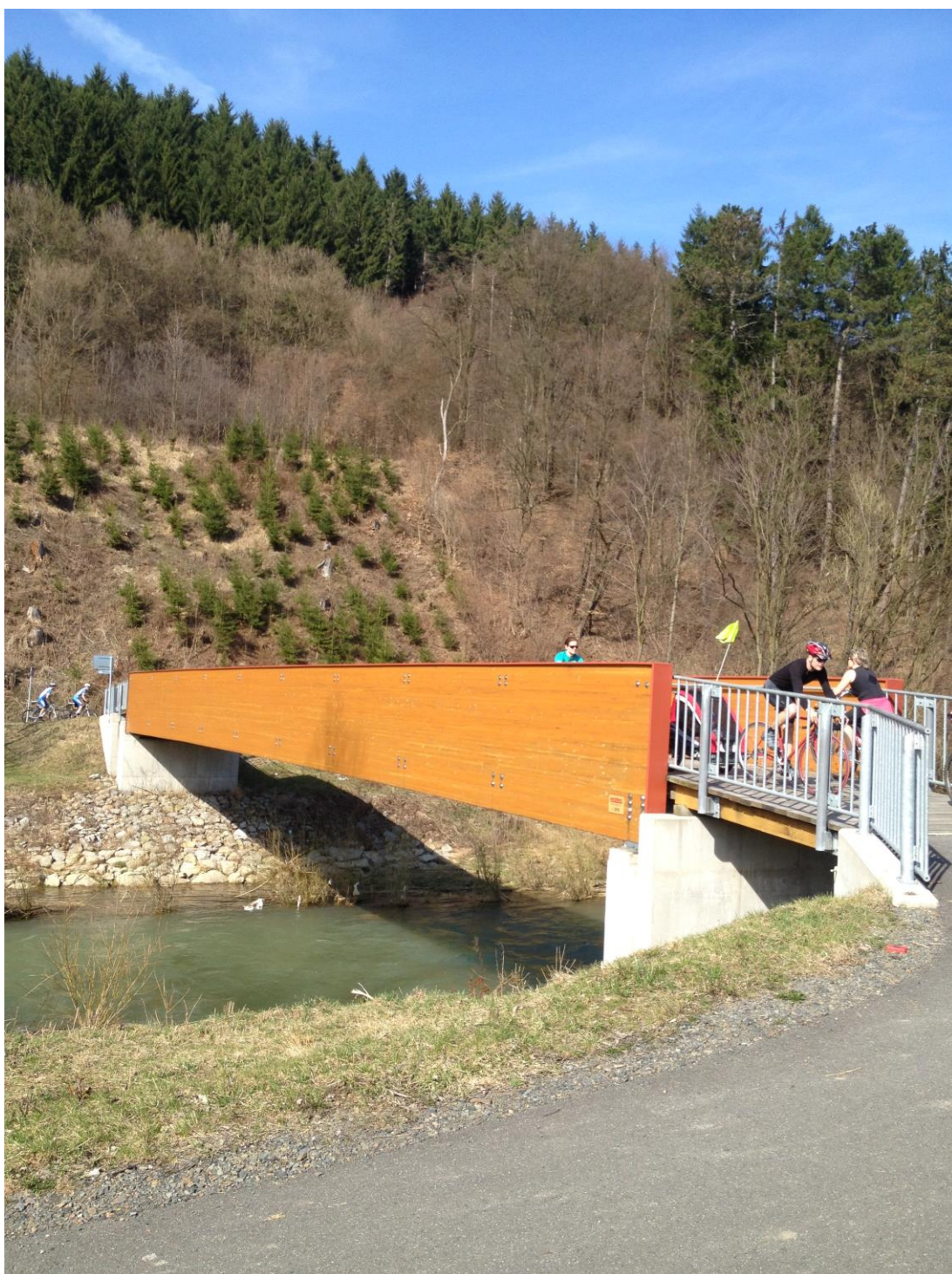
Dřevěný most přes řeku Bečvu (fotografie pořízena na úseku Cyklostezky Bečva v obci Janová)
