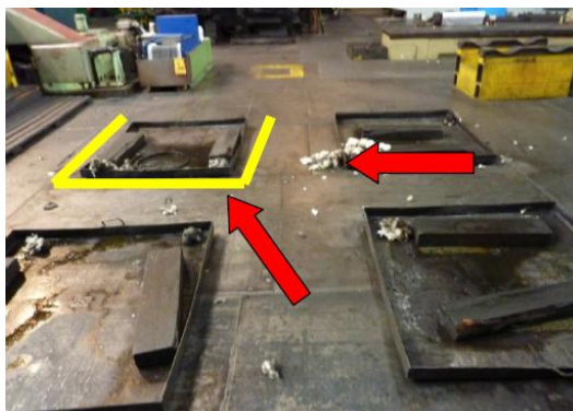
Obrázok 69: Nedostatočné vodorovné značenie (vlastné spracovanie)
