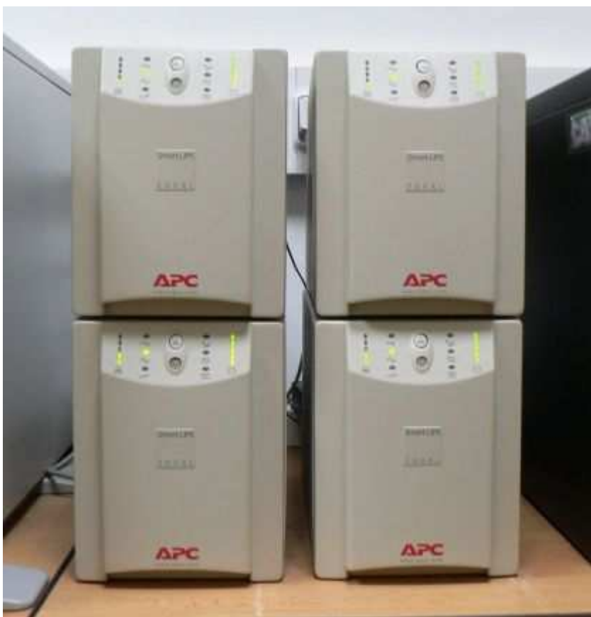
Obrázek 8 Záložní zdroje UPS v serverovně
