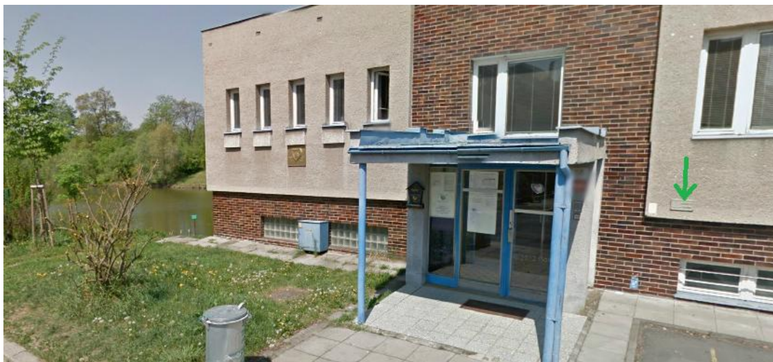
Obr. 9. Vyznačení dosahu vody při povodni v roce 1997 na budově Českého rybářského svazu u městského rybníka v Přerově [vlastní]
