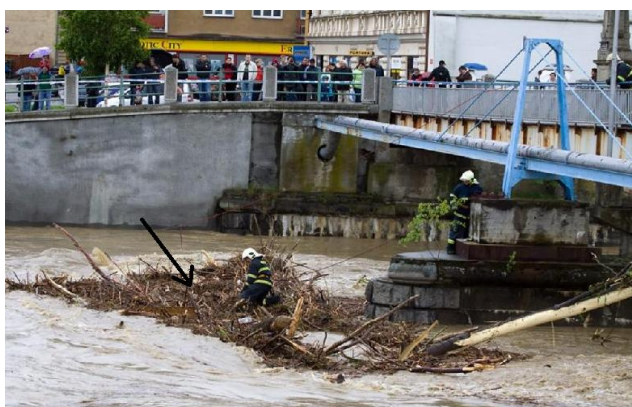
Obr. 7. Záběr hasičů při odstraňování naplavenin z pilířů mostu [vlastní]
