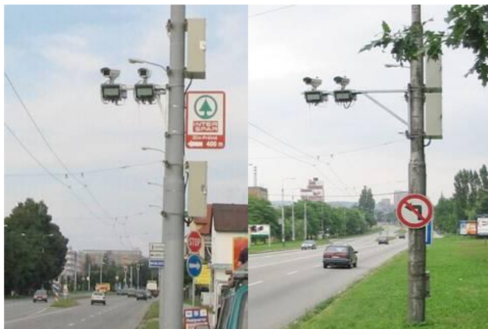
Obr. 10. Kamery MKDS napájené z veřejného osvětlení [26]
