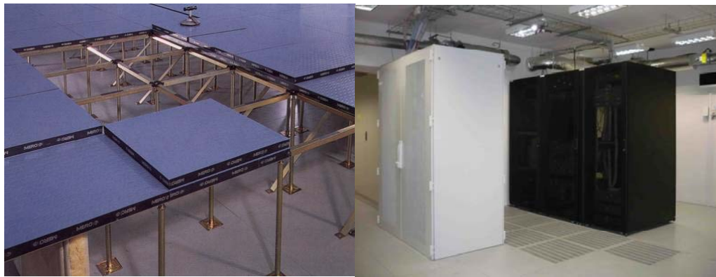
Obr. 8. Dvojitá podlaha a instalace kabelů.
