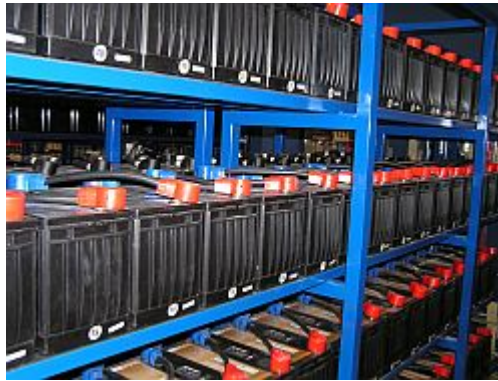
Obr. 13. Umístění baterií UPS [14].
