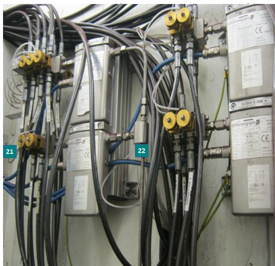
Obrázek 24: Pumpy a slučovač barvového hospodářství
