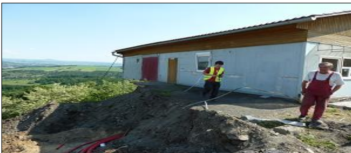
Obr. 4 Sesuv u dálnice D8 [32]
