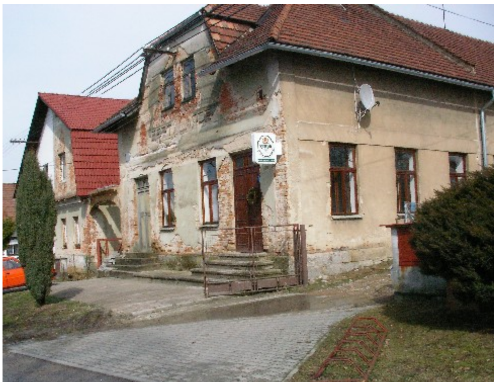
Budova Hostince – nutná rekonstrukce
