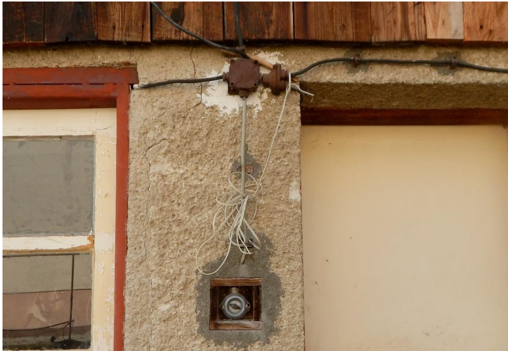
Obr. 8 Vypínač, rozvodka a káble
