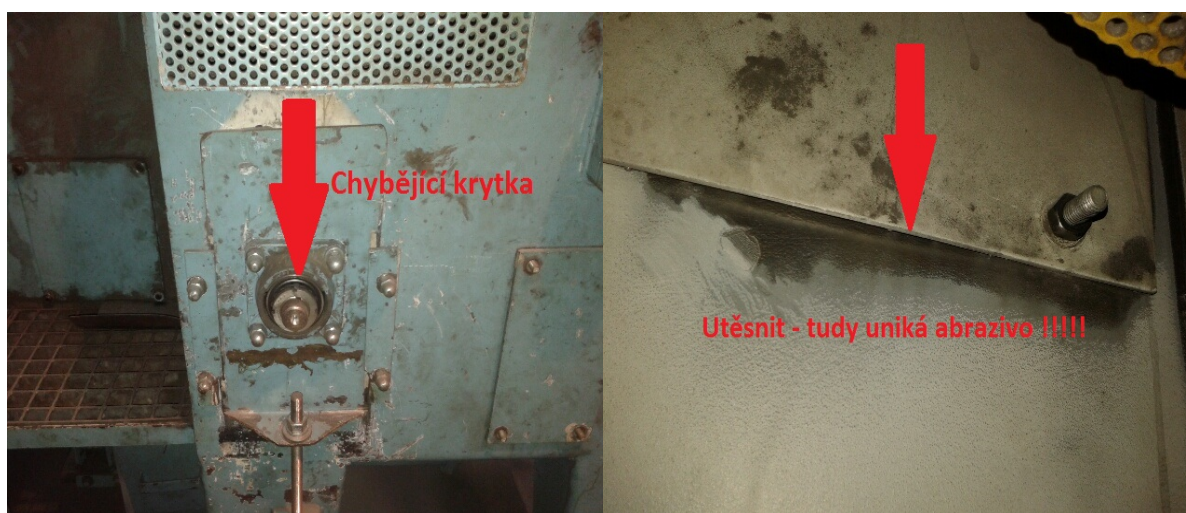
Obr. 62. Ukázka závad a nedostatků na bubnových tryskačích
