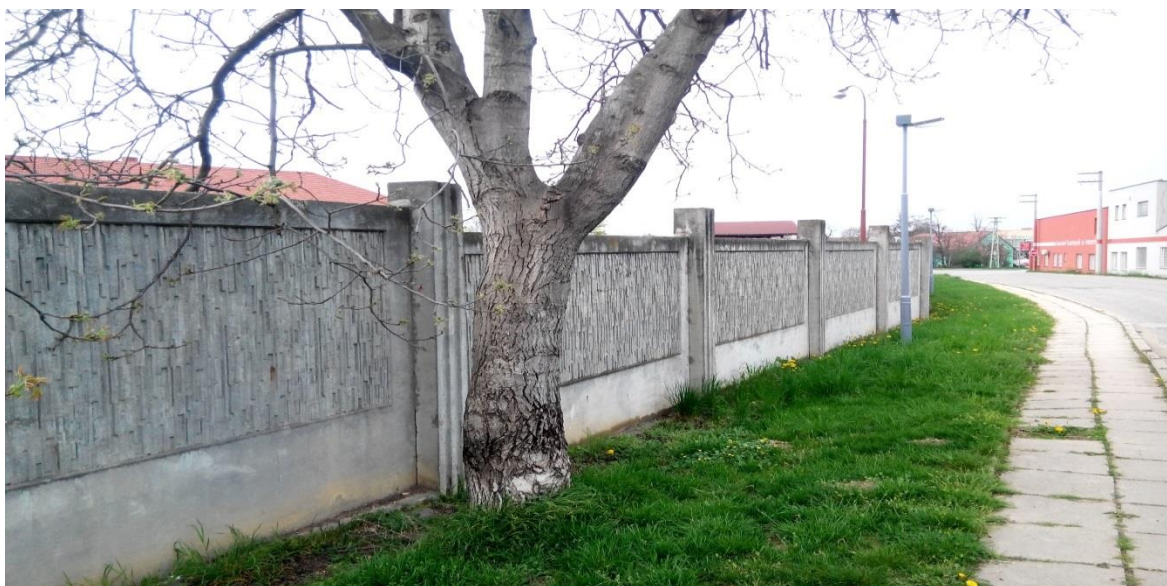
Obrázek č. 14- Obvodová ochrana areálu, pohled z východu [Zdroj: autor]
