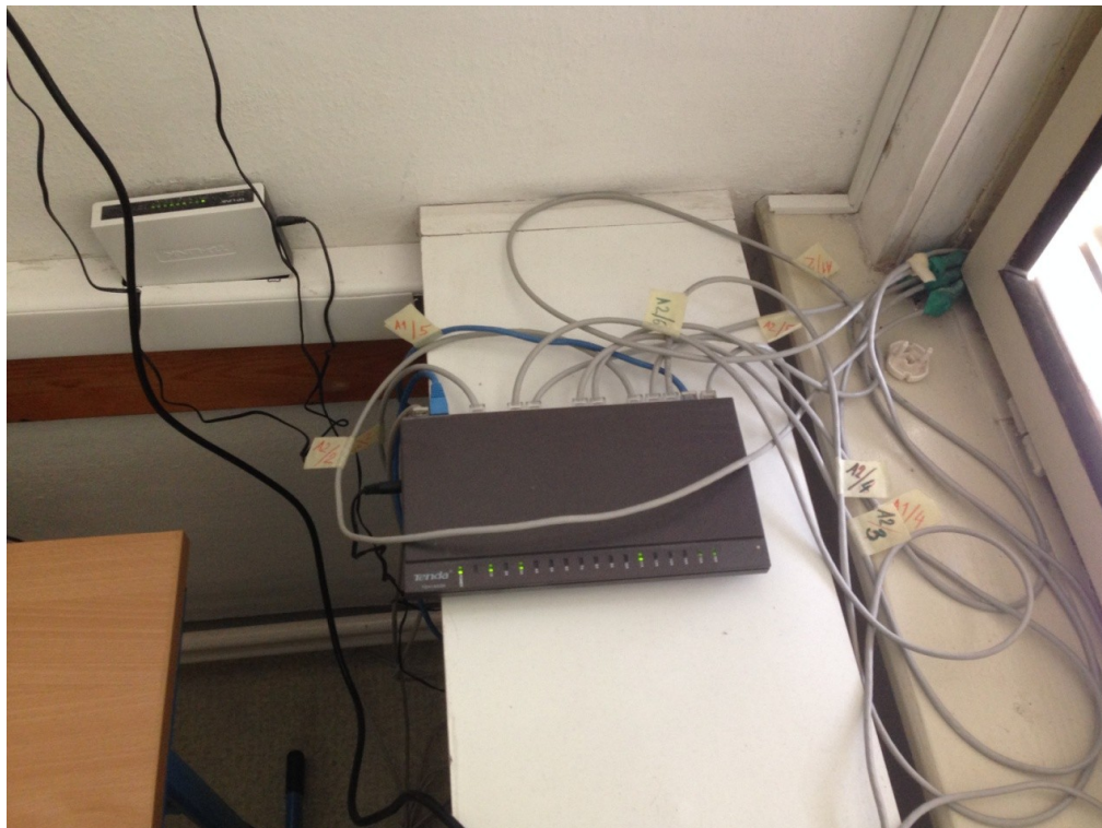
Obr. 64. Spleť káblov vedená cez okno
