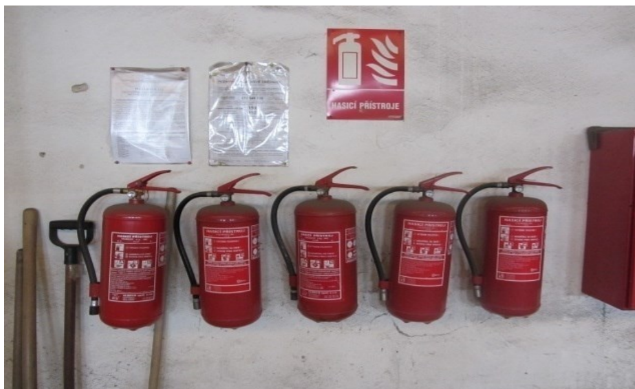
Obr. 20. Práškové hasicí přístroje v nezatepleném skladu [22]
