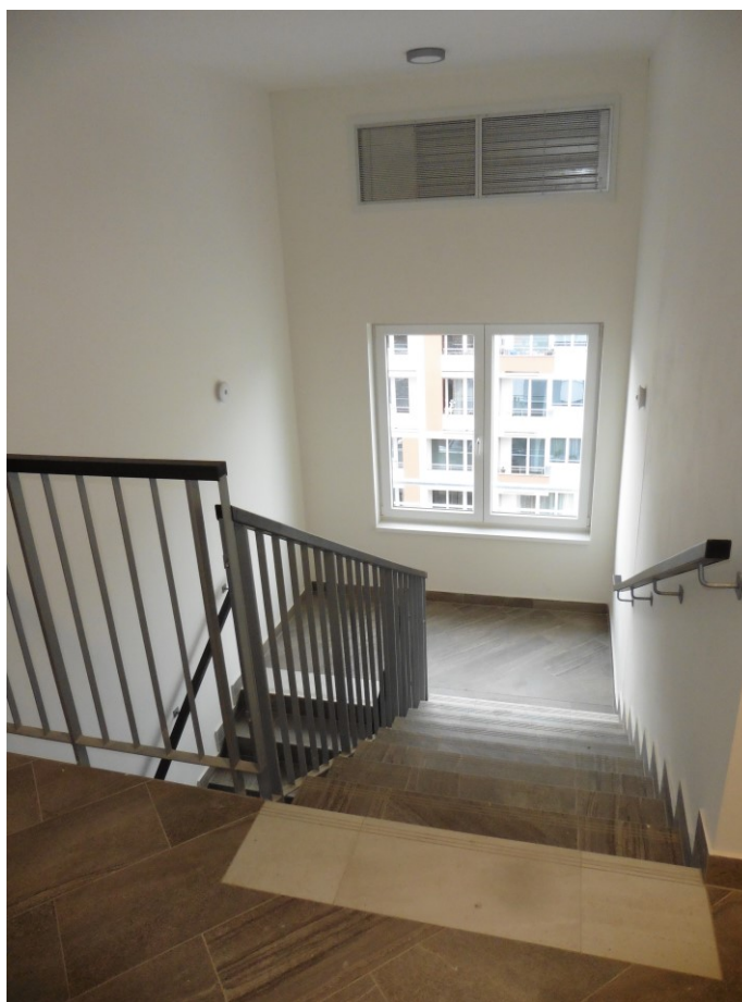
Obr. 23 Nejvyšší podlaží schodiště CHÚC B - větrací klapka ovládaná Bezpečnostní centrálou, zdroj: [vlastní]
