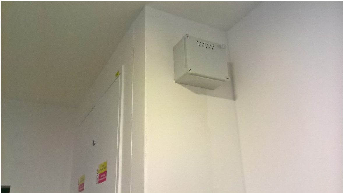
Obr. 24 Nejvyšší podlaží schodiště CHÚC B - diferenční spínač tlaku, zdroj: [vlastní]
