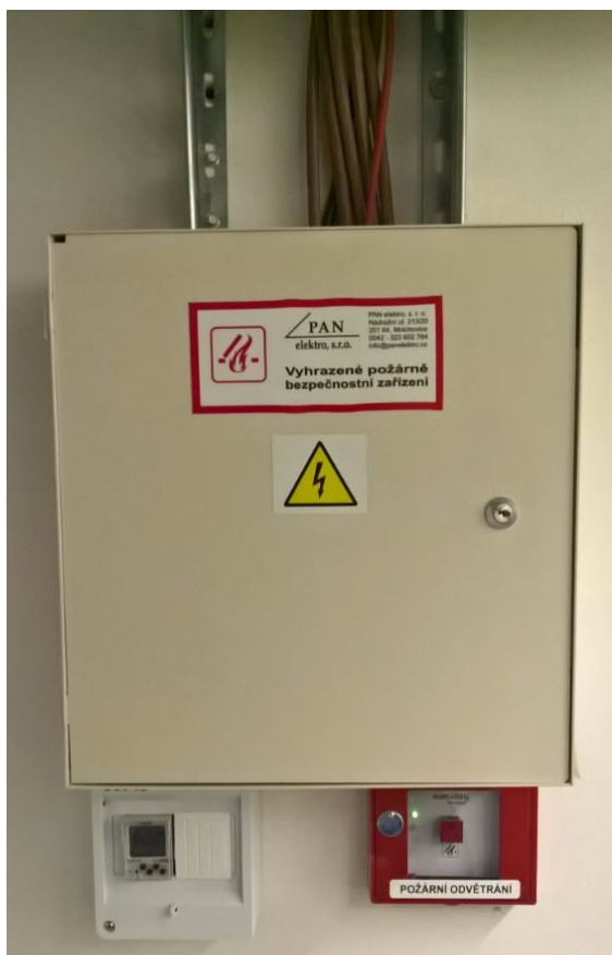
Obr. 21 Bezpečnostní centrála s ovládacím tlačítkem a externími hodi-nami, zdroj: [vlastní]
