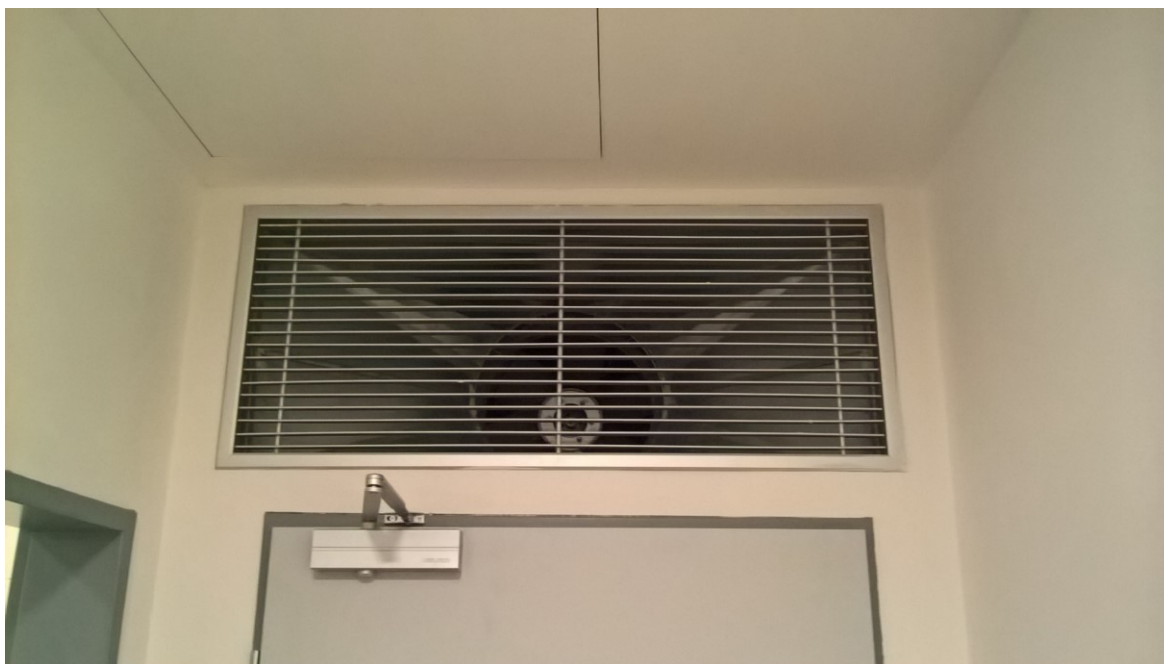
Obr. 22 Ventilátor se stěnovou mřížkou v 1.PP CHÚC B, zdroj: [vlastní]
