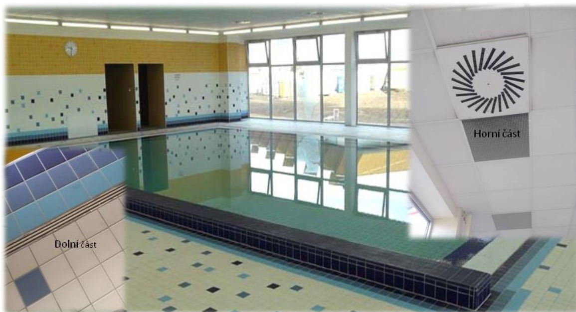
Obrázek 17 Klimatizace ve výukovém bazénu 56
