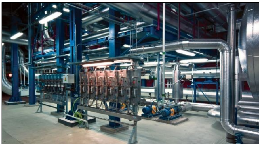
Obr. 8. Centrální výměňková stanice (archiv společnosti XYZ, a.s.).
