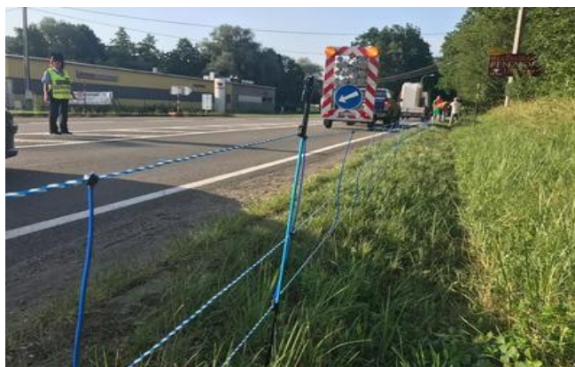
Obrázek 5-Nainstalovaný elektrický ohradník podél silniční komunikace
