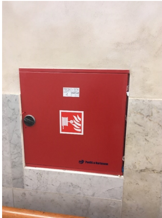
Obrázek 12 – Hydrantový systém v chodbě k čekárně ČD [Zdroj: vlastní]
