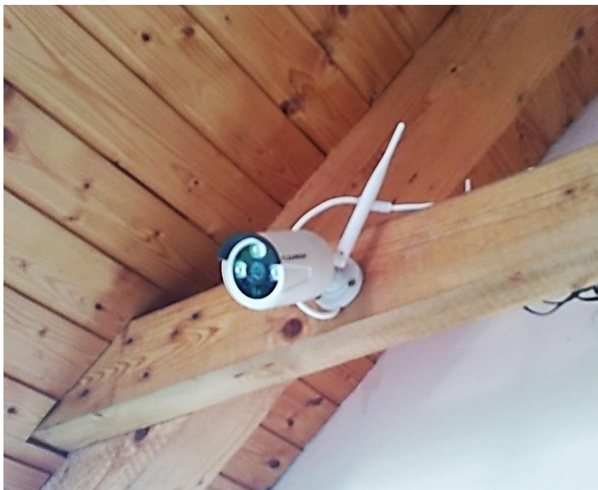
Obrázek 31: Umístění kamery v objektu [zdroj: autor]
