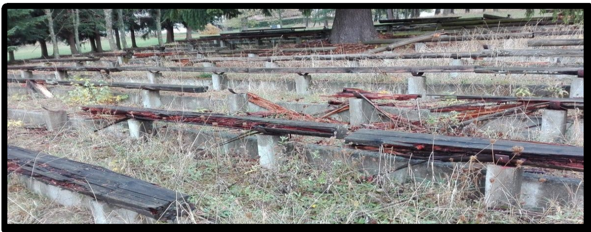
Obrázek 3 Havarijní stav laviček u amfiteátru na Ploštině
