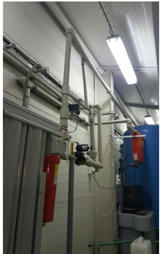
Obrázek 7 - Trubkové rozvody dusíku
