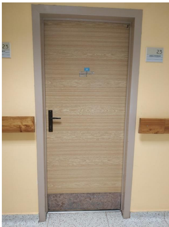
Obrázek 7 – Protipožární dveře [Vlastní]
