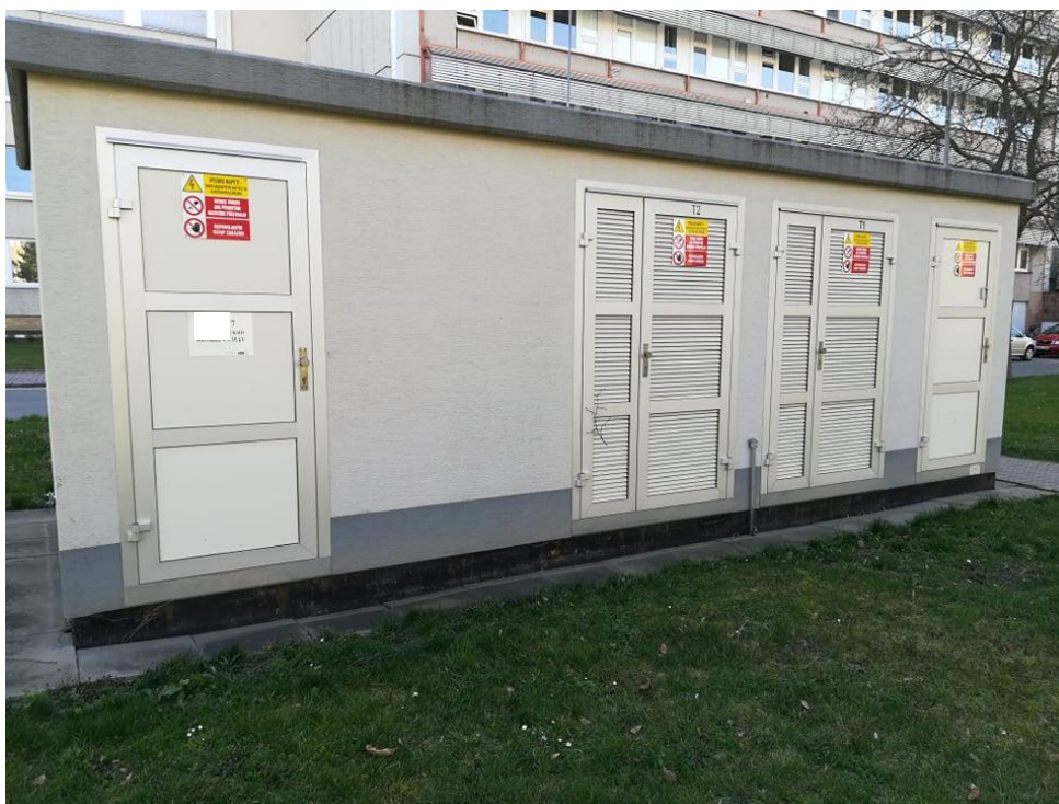
Obrázek 7 – Nejnovější typ rozvodny [zdroj: vlastní]
