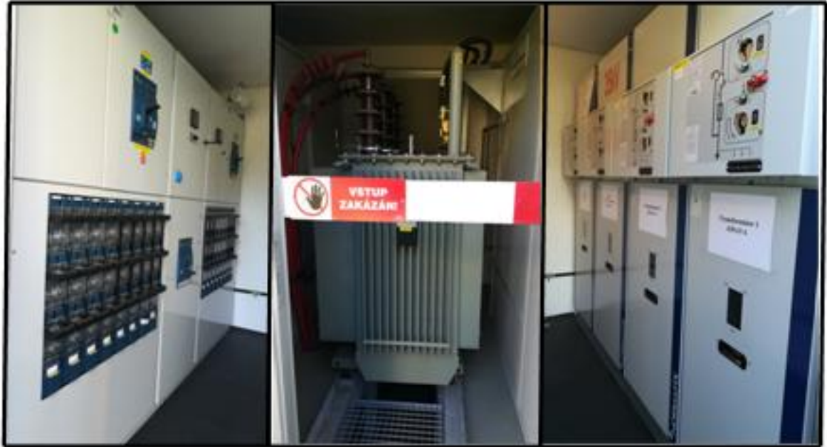
Obrázek 8 – Moderní rozvodna el. energie (vnitřní pohled) [zdroj: vlastní]
