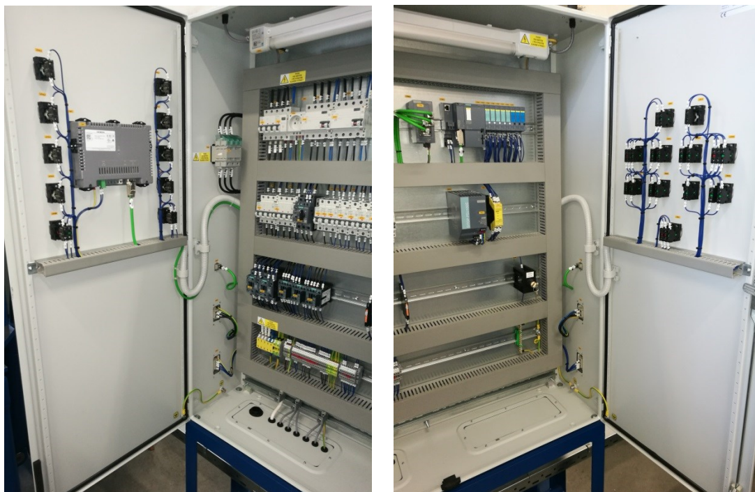
Obr. 60. Zapojená skříň společného elektrorozvaděče
