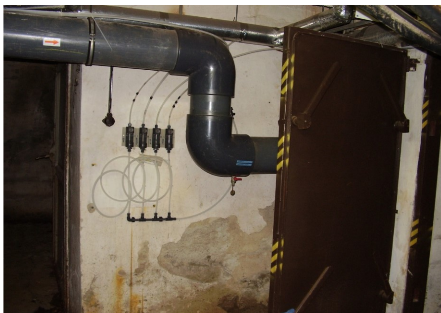
Obrázek 18 – Injektor s chlórem („nástěnka“) (Fojtík, 2020, str. 44)
