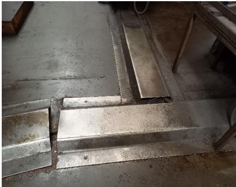
Obrázok 20 – Elektrické vedenie k strojom ťahané pod kovovými chráničkami (vlastná fotografia)
