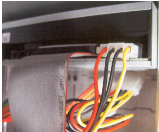
Obr. 24. Připojení datového a napájecího kabelu k „PATA“ mechanice
