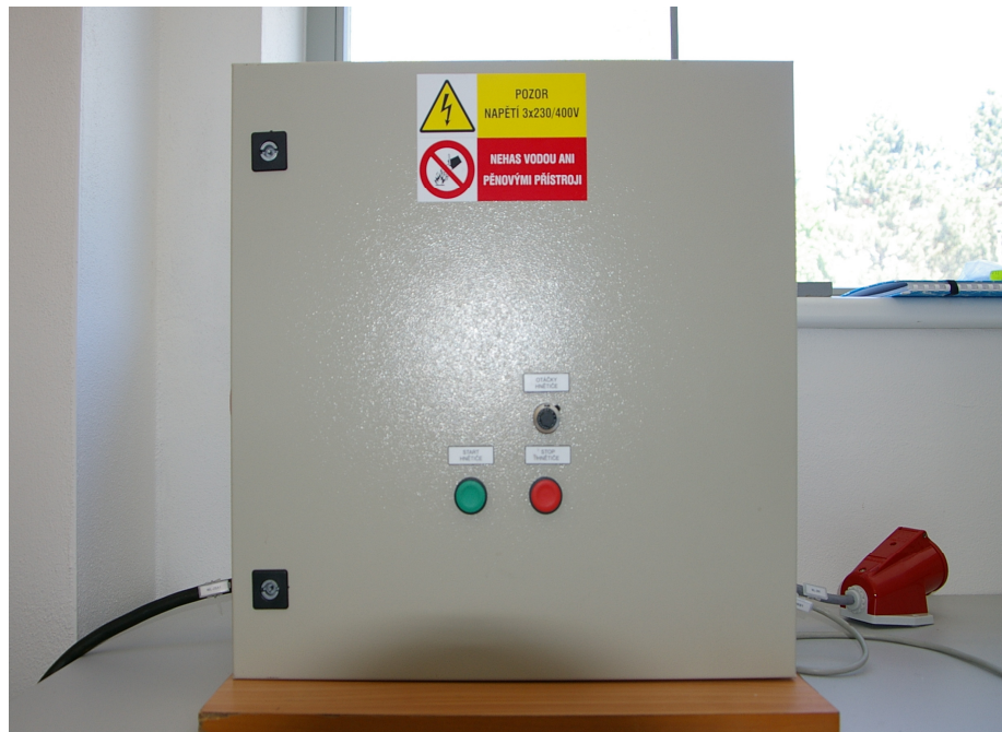
Obr. 9 – Frekvenčný menič, zelené tlačílo- zapnutí motora, červené tlačílo- vypnutí motora, čierne kolečko- regulácia otáčiek
